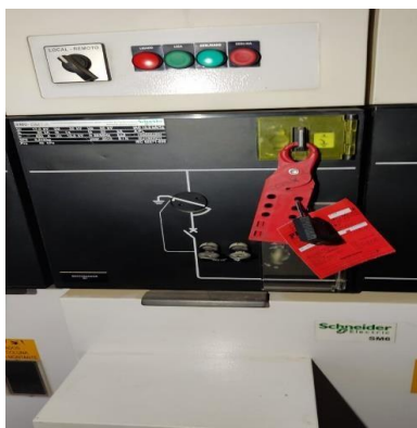
Figura 03 – Disjuntor de alta tensão bloqueado
