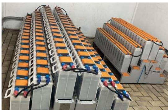
Figura 7: Banco de bateria
