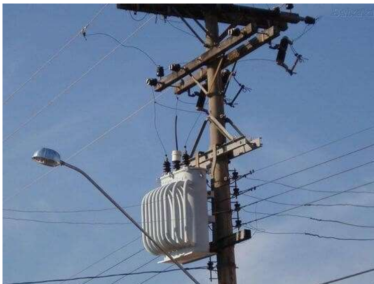
Figura 6: REDE DE DISTRIBUIÇÃO AÉREA COMPACTA [6]
