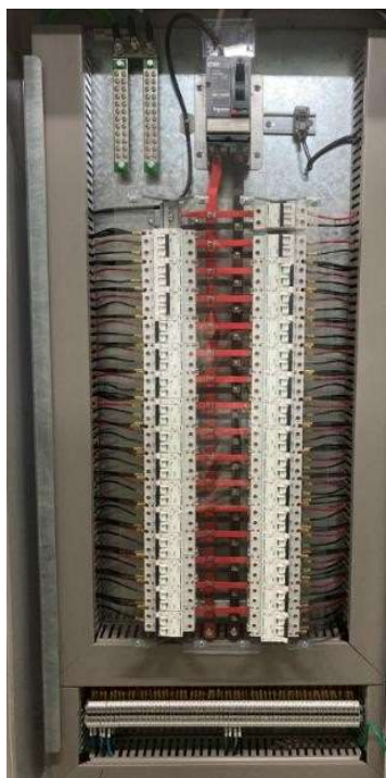
Figura 8: Quadro de Distribuição de Carga (QDC)
