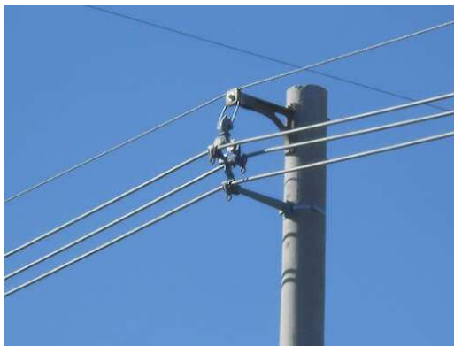
Figura 5: REDE DE DISTRIBUIÇÃO AÉREA COMPACTA [5]
